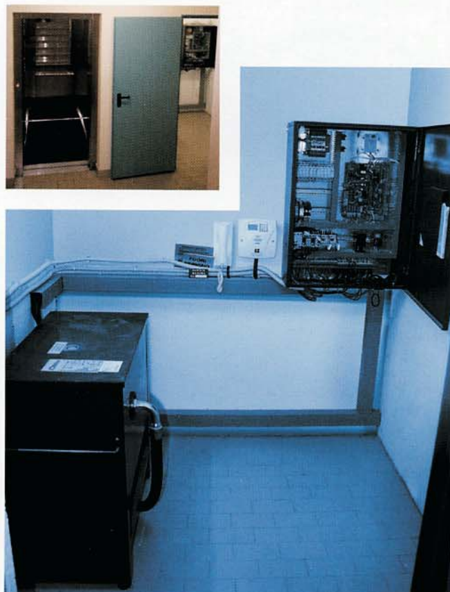
Per il serbatoio dell'olio può essere utilizzato il locale macchina. The former machine room space for the pump unit and controller can be recovered.
